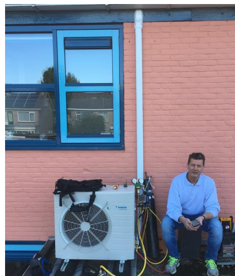
Installatie buitenunit hybride warmtepomp
