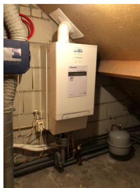
Aan de achterzijde van de cv-ketel zit de binnenunit van de hybride warmtepomp
